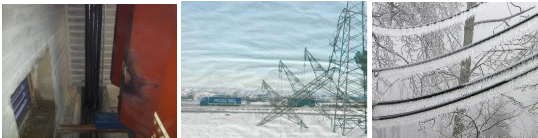
Figura 10.- Daños provocados por la nieve en equipamientos eléctricos: transformador, torreta, cableado
