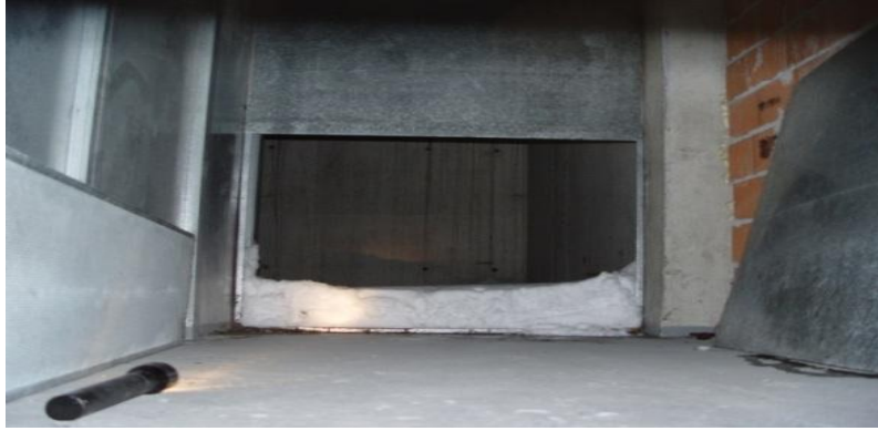
Figura 9.- Parte inferior de la chimenea de admisión de aire semiobturada por la nieve
