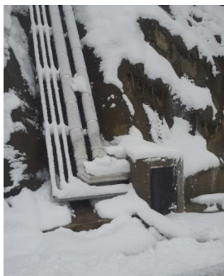
Figura 13.- Tubería de alimentación de agua que debe protegerse
