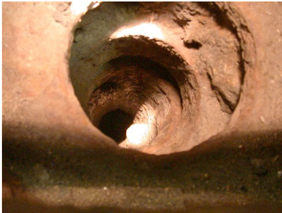
(a) Conduite obstruée à 55%
