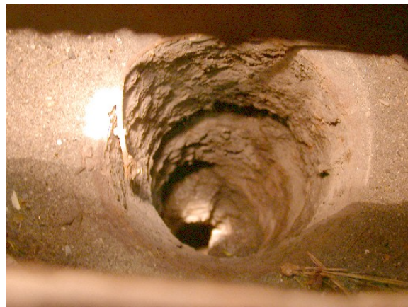
(b) Conduite obstruée à 97%
