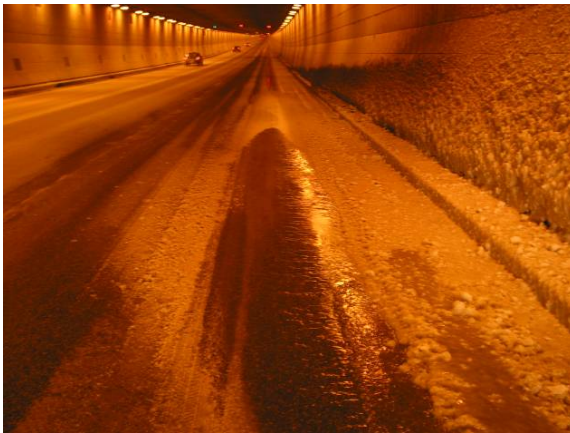
(a) Plaques de glace sur la chaussée
