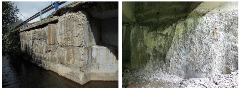
Figura 13 Daños en muro lateral y en estribo por hielo deshielo
