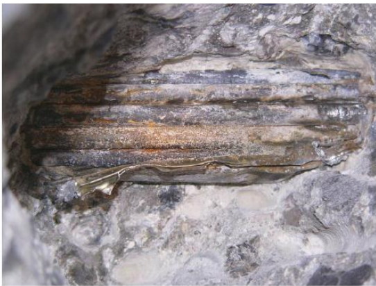
Fig. 6. Armature de précontrainte corrodée sous l'effet des chlorures.
