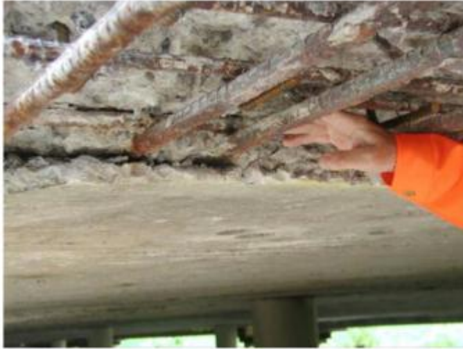
Fig. 1. Tablier de pont soumis aux sels de déverglaçage.
