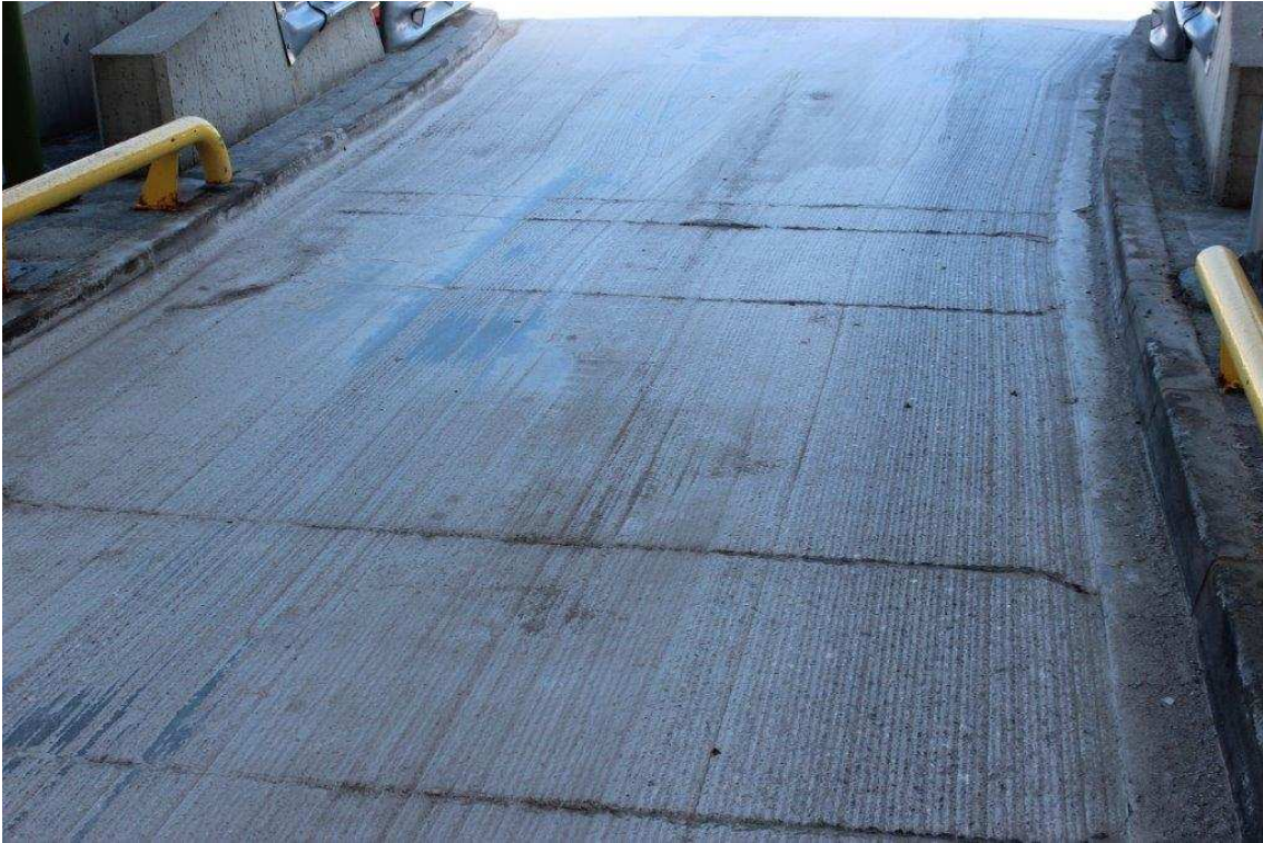
Fotografía 6. Detalle de la rugosidad obtenida para incrementar la seguridad de los usuarios
