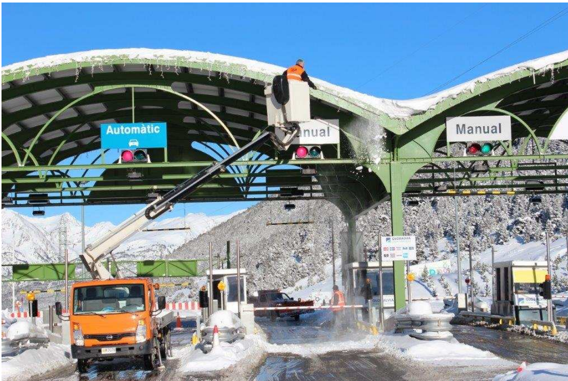
Fotografía 16. Detalle de la retirada de la nieve acumulada sobre la marquesina.
