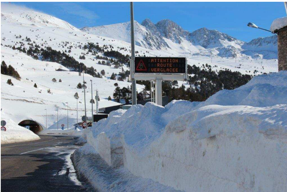
Fotografía 22. Panel de señalización variable.
