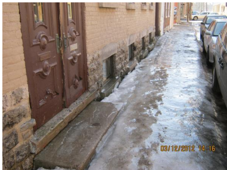
Photo 6 – Glace formée par l'eau d'une toiture qui dégoutte sur le trottoir
