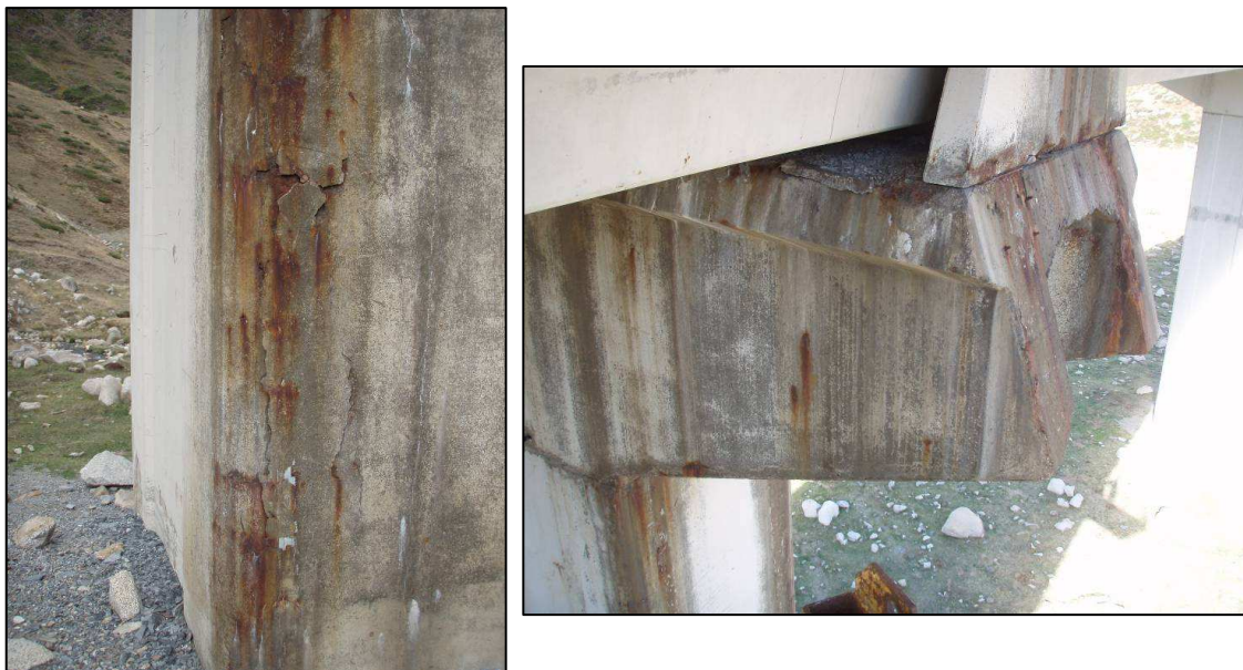
Figuras nº 14 y nº 15. Detalle de lajaciones, pátinas, armaduras vistas y alteración superficial del hormigón en pie de pila nº 2 (arriba, izquierda) y detalle del cargadero de dicha pila (arriba, derecha)
