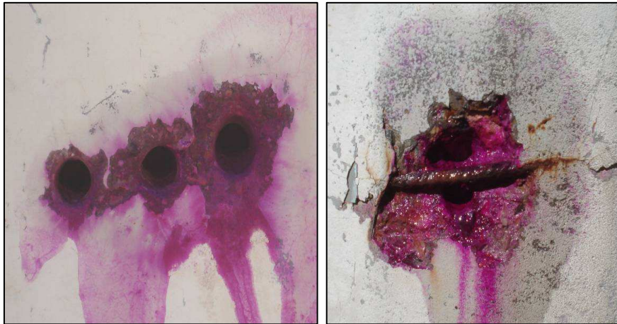
Figuras nº 17 y nº 18. Avance del frente carbonatado en pilas nº 2 y nº 3 respectivamente
