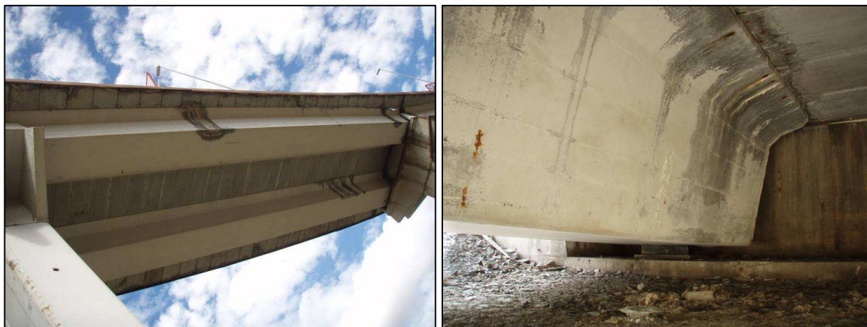
Figuras nº 10 y nº 11. Alteración superficial del hormigón en vigas, con presencia de armaduras vistas de forma puntual
