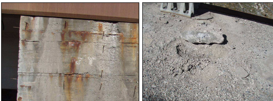
Figuras nº 12 y nº 13. Degradación del hormigón en estribo nº 2 (izquierda) y Alteración superficial del zócalo izquierdo del vano nº 1 (derecha)
