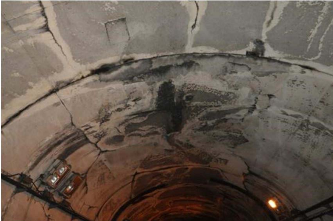
“Fotografía 9 - Degradación del hormigón de revestimiento del Túnel de Bielsa – Aragnouet”
