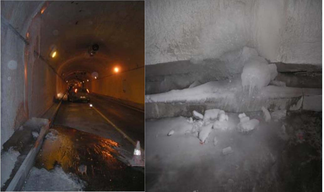
“Fotografías 3, 4 - Formaciones de hielo en la calzada en el Túnel de Bielsa – Aragnouet”
