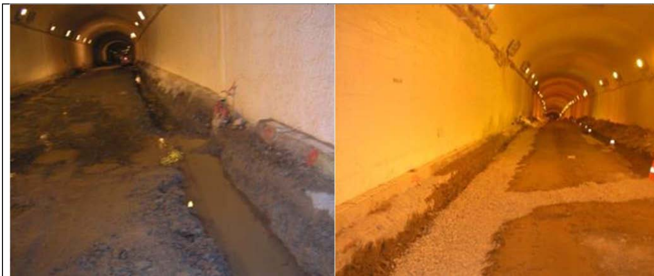
“Fotografía 12 - Presencia de agua en plataforma y zanjas drenantes realizadas”
