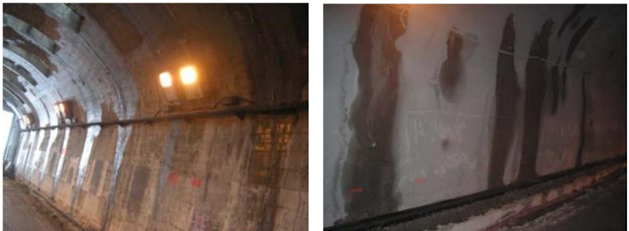
“Fotografías 7, 8 - Filtraciones en el Túnel de Bielsa – Aragnouet”
