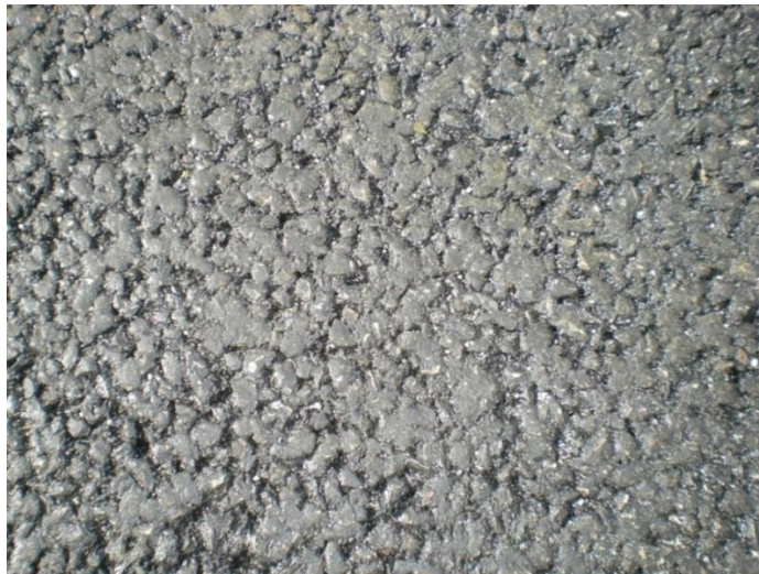
Foto 4. Aspecto de la textura de la mezcla BBTTM 11A con producto antihielo
