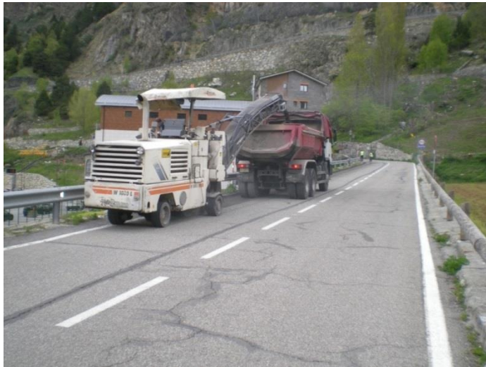
Foto 3. Aspecto de la calzada antes de la actuación
